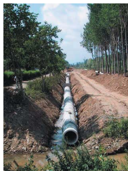
Colectores de aguas residuales
