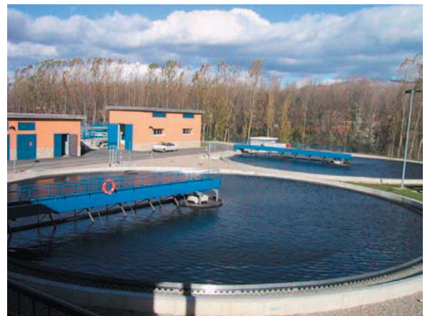
Proceso de clarificación en la EDAR del Bajo Oja-Tirón
