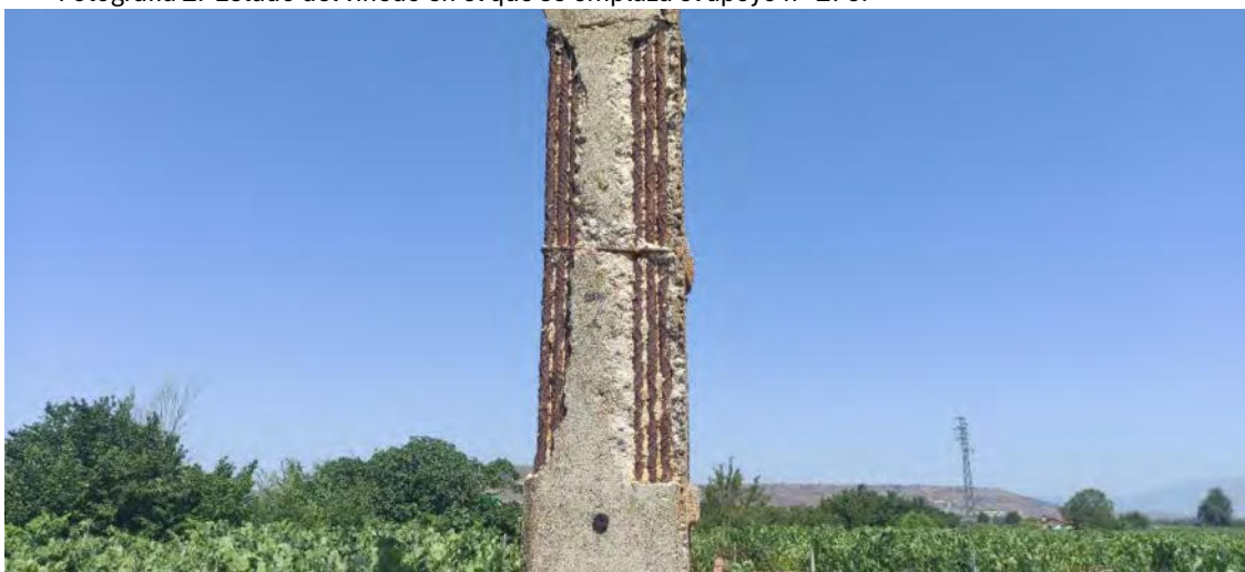
Fotografía 3. Estado de deterioro del actual apoyo nº 276.
