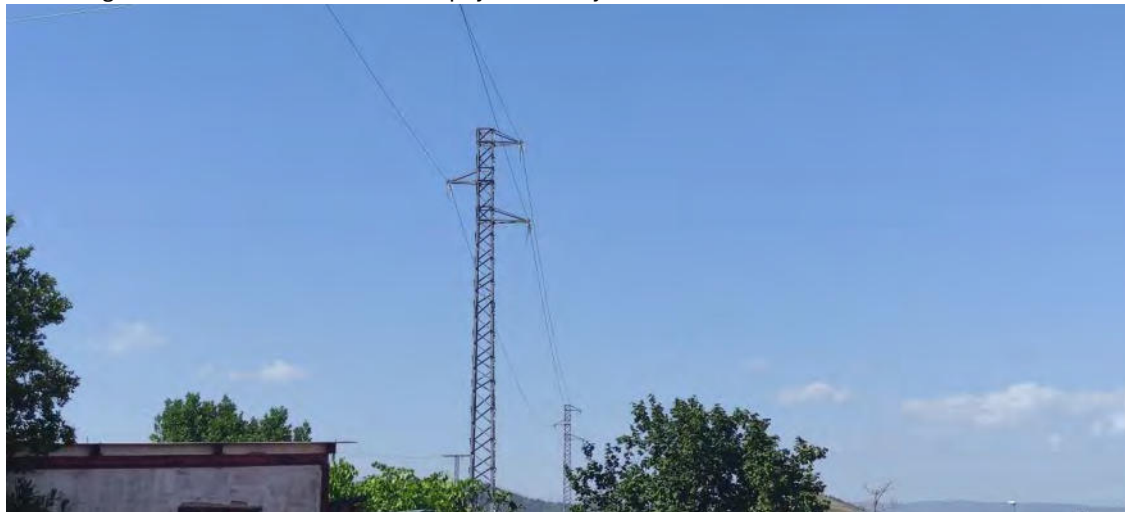
Fotografía 5. Apoyo nº 398 a mantener.
