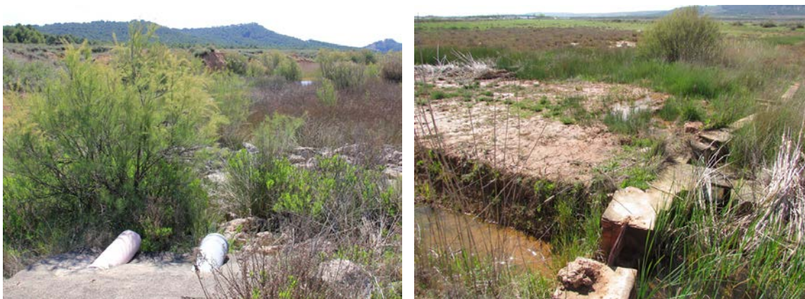
Foto 30: Salida de agua de fondo de la balsa de La Degollada L1 hacia L2 y L3 en la yasa.
