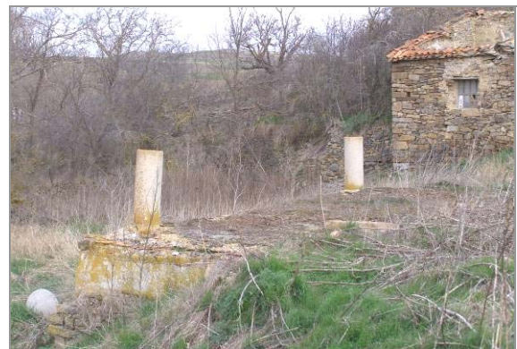
Pozo séptico de Palacio de San Pedro, sin mantenimiento.
