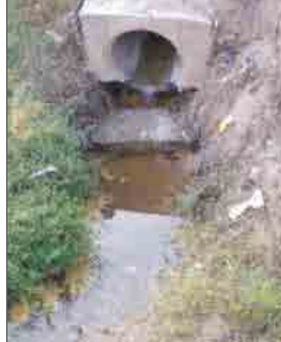
Vertido de aguas residuales de Budenheim y Foret
