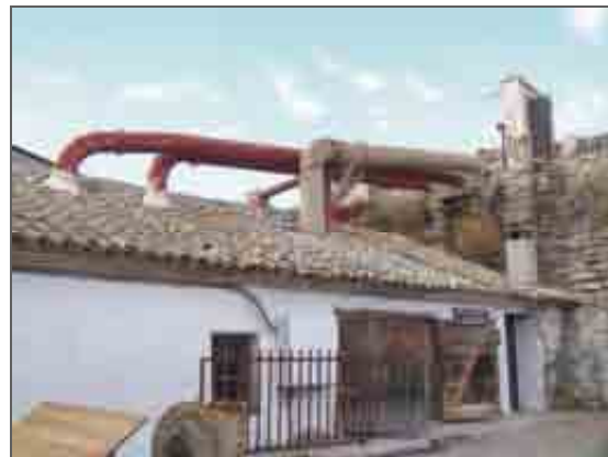
Tuberías que conducen el agua al canal elevado de la comunidad de regantes de la Acequia El Molino (CR de Gelsa)
