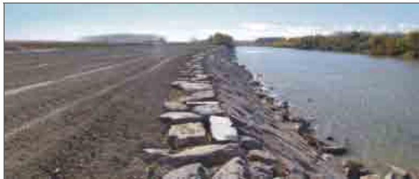
Escollera de refuerzo de protección de la mota que protege a Remolinos, sobre la margen izquierda del río en el termino de Boquiñeni (paraje el Cartadero). El avance del soto sobre la margen derecha ha hecho la defensa insuficiente en las últimas avenidas
