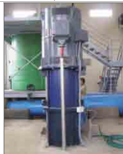
Instalaciones de la estación de bombeo de la comunidad de regantes Las Lomas en Quinto de Ebro
