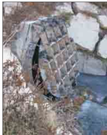
Clapeta para aguas pluviales de la conexión de las aguas residuales del polígono de Malpica a la EDAR de la Cartuja. El día de la visita hay una fuga de agua.
