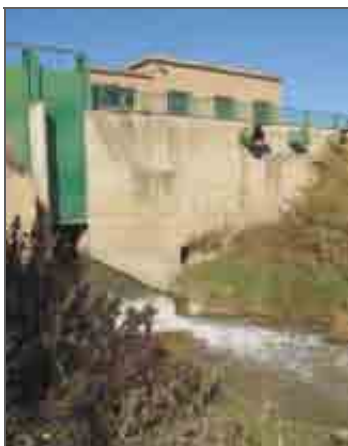
Escurridero y bombeo en paraje El Chopar en Pradilla utilizado en épocas de avenida para el drenaje de los campos anegados. En el 2007 se abrieron las compuertas para inundar los campos anegados.
