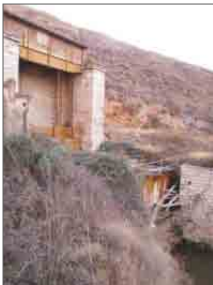
Entrada del túnel del canal de la central hidroeléctrica de Sástago II.
