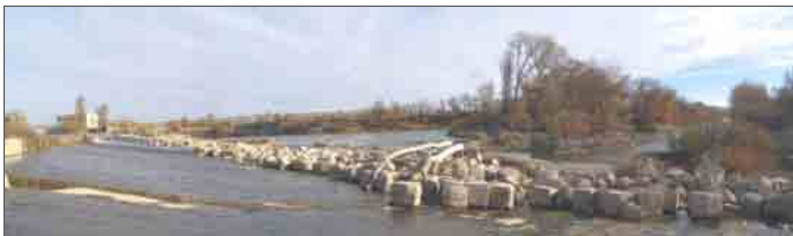
Vista de la presa de la CH de Pina, donde se deriva agua a las acequias de Fuentes de Ebro en la margen derecha y la acequia de Quinto en la margen izquierda. En el momento de la visita se estaba limpiando y saneando la zona de aguas abajo del azud. La presa tiene escala de peces.
