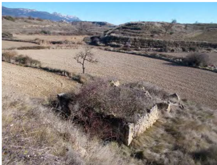
Foto 22 Edificación arruinada de mampostería, localizada en el fondo de la vaguada de El Palomar.
