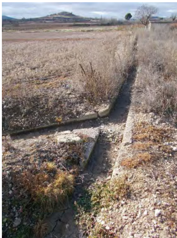
Foto 31 Atarjeas de hormigón abandonadas, localizadas en el paraje de San Millán.
