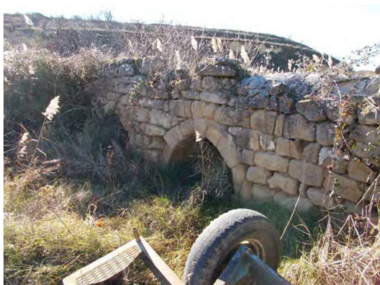
Foto 25 Detalla de dos arcos del puente acueducto construido sobre el arroyo de El Palomar.
