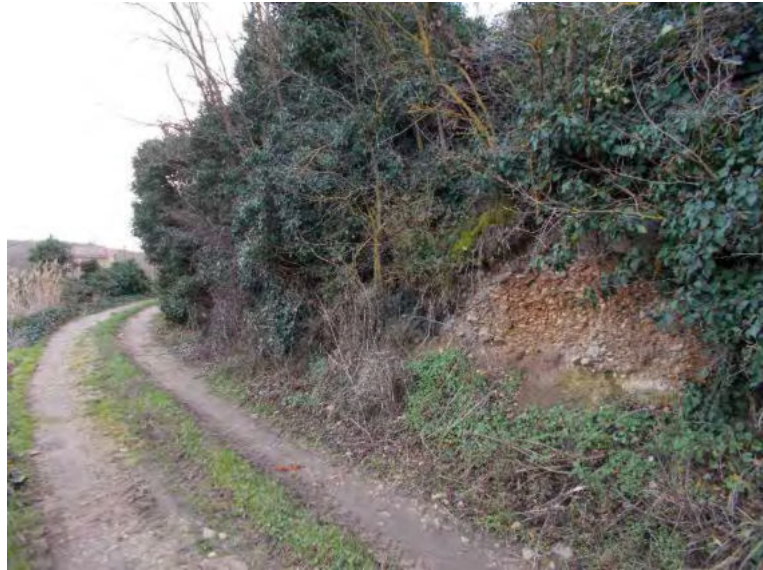
Foto 40 Afloramiento de gravas de la segunda terraza del Ebro, al pie del flanco septentrional de la ermita de Santa Lucía.
