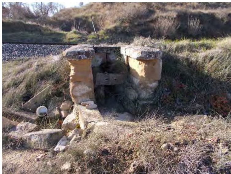
Foto 3 Salida de la atarjea construida bajo la vía férrea para el paso del canal de la margen izquierda del arroyo Zamaca.
