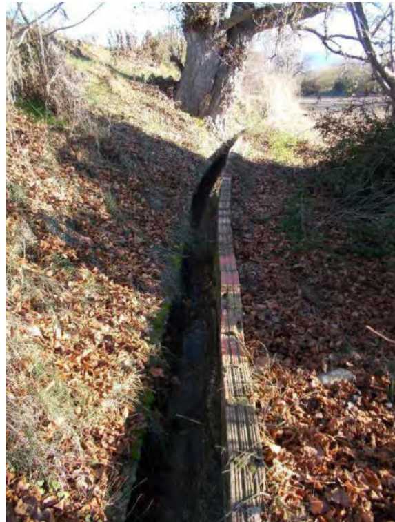
Foto 11 Detalle del canal de la margen izquierda del arroyo Zamaca, construido con hormigón y reparado con ladrillos.
