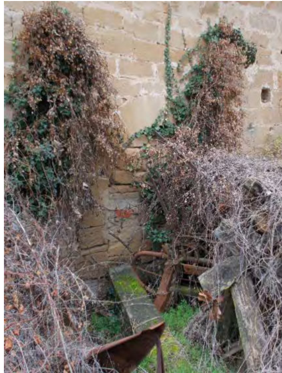
Foto 49 Ermita de Santa Lucía. Detalle del muro meridional de la fábrica románica, con una puerta bajo arco de medio punto, tapiada.
