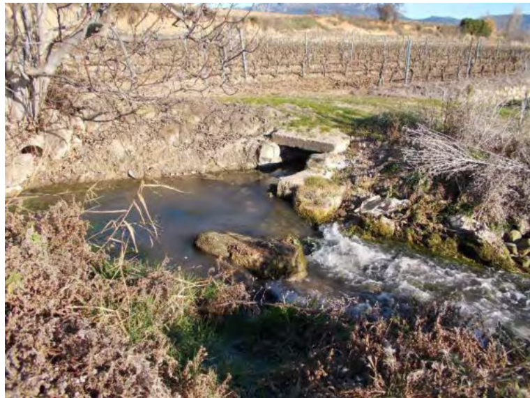
Foto 10 Derivación del canal de la margen izquierda del arroyo Zamaca.
