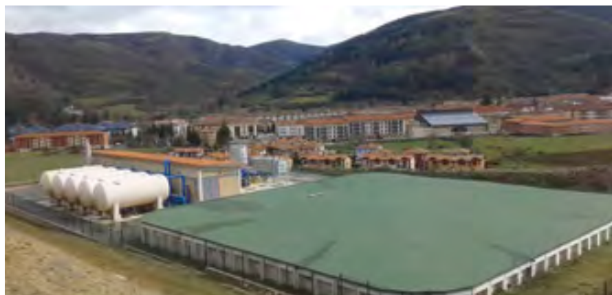
Potabilizadora del "Oja-Tirón", en Ezcaray.
