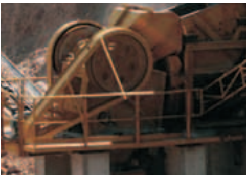
Detalle de las protecciones de las partes móviles del equipo de trituración. Barandillas y rodapiés en las plataformas
