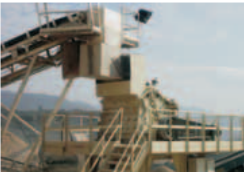
Plataforma de trabajo. Acceso por escalera con pasamanos. Barandillas, quitamiedos y rodapiés. Partes móviles protegidas. Sistemas de iluminación
