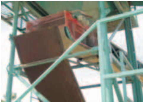
Detalle de las protecciones de las partes móviles. Bandeja anti-caída de objetos
