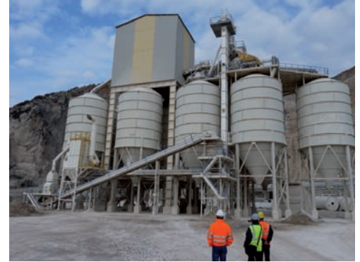
Planta de hormigón, compuesta de silos para cemento, aditivos, áridos y mezcladora
