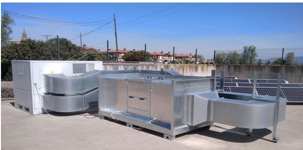
Imagen del demostrador instalado en Zarratón (La Rioja) para su validación técnica.
