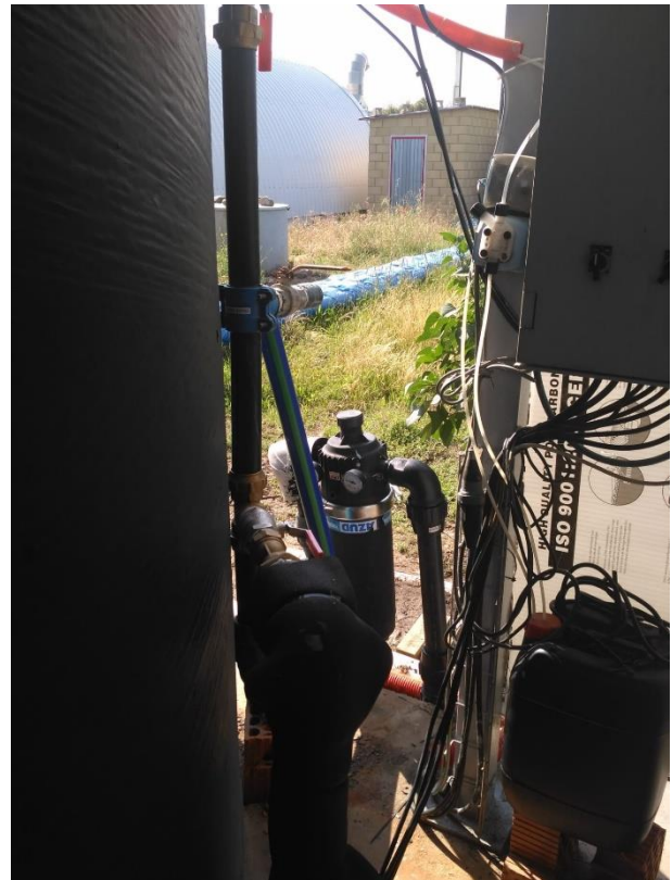
Foto 4. Bombas de recirculación del agua.
