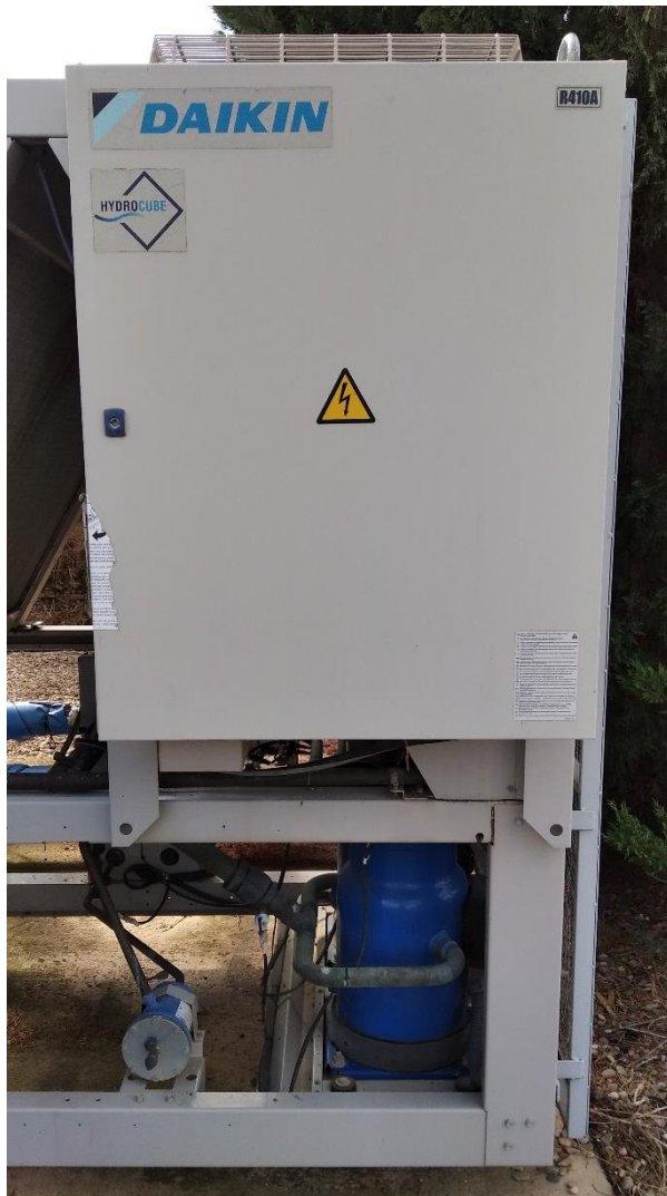
Foto 3. Enfriadora Daikin EWA003DAYNS R410A I
