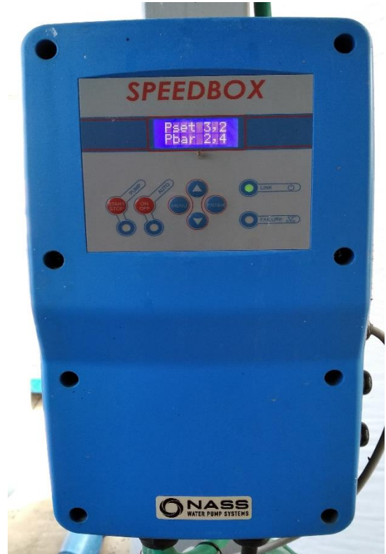
Foto 8. Centralita control distribución
