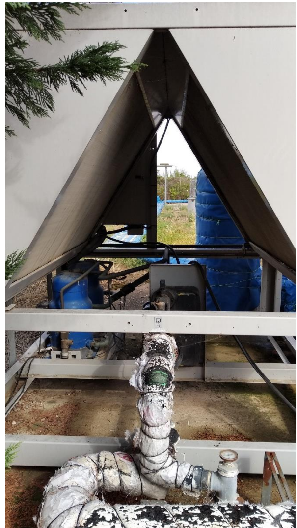
Foto 4. Enfriadora Daikin EWA003DAYNS R410A II
