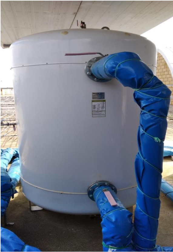
Foto 5. Depósito de inercia
