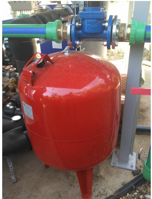
Foto 6. Calderín de expansión.
