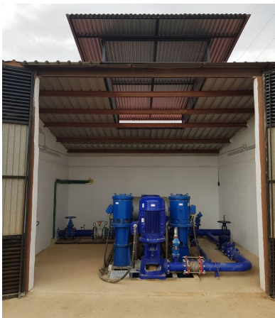
Foto caseta y parte hidráulica.
