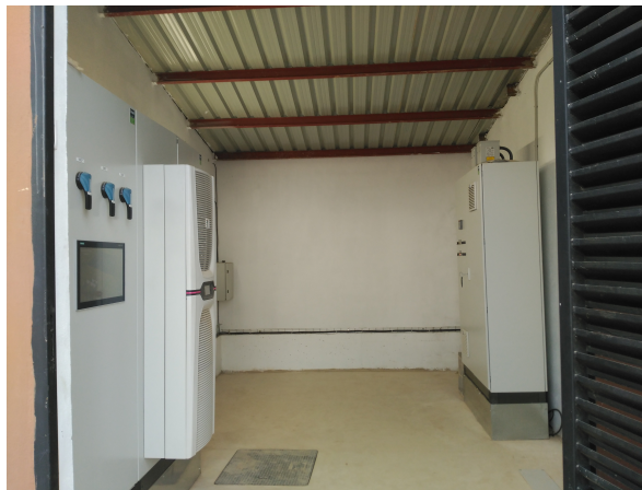
Foto caseta y parte eléctrica.
