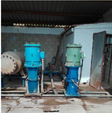
Foto Izquierda Bombeo previo a proyecto.
