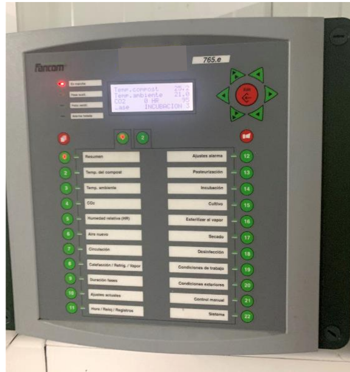
Equipo de control de climatización
