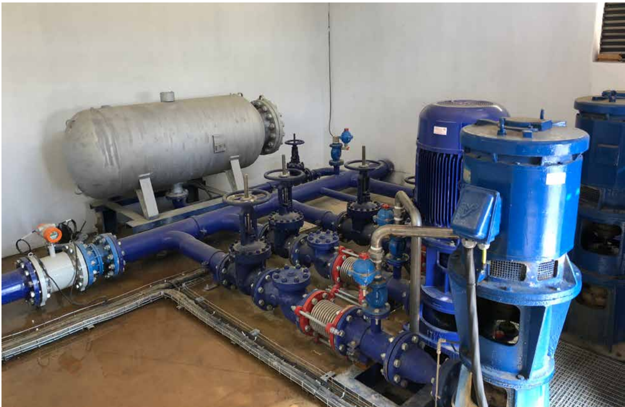
Las bombas funcionan con la energía solar para impulsar hasta una balsa elevada el agua captada en el canal de Lodosa. /Rubén Alcázar (IMEL)
