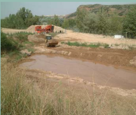
Balsa de lodos. Los sólidos se depositan y las aguas claras retornan al circuito de lavado de arenas. El lodo seco se retira con pala cargadora y se lleva, en camiones, a las áreas a restaurar
