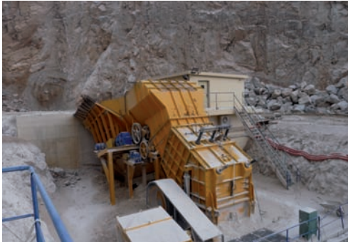
Inicio del circuito primario
