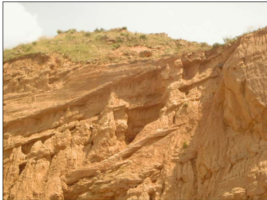
FALLAS DE LA CARRETERA DE ARNEDO
