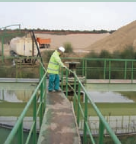
Sistemas de clarificación de las aguas de proceso
