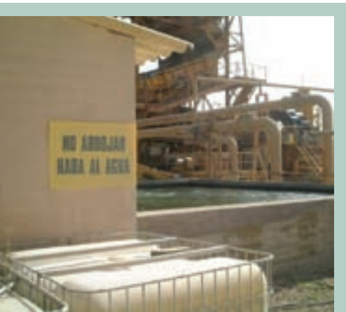
Depósito de recirculación del agua de proceso
