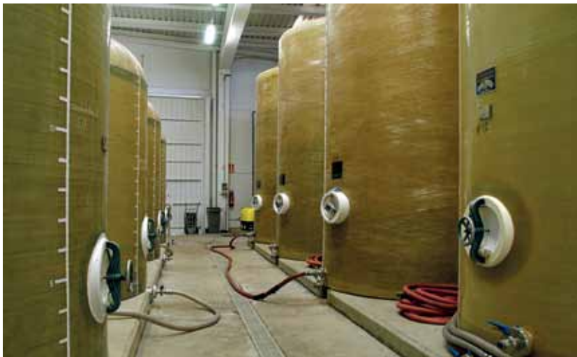
Depósitos de fermentación de Vinagreras de Haro.
